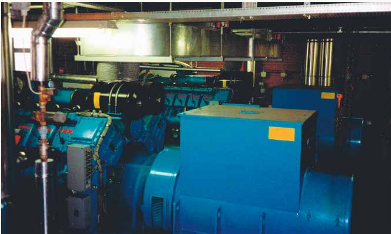
Varmeværkets 2 nye Deutz MWM-motorer installeret i den nye tilbygning på varmecentralen
