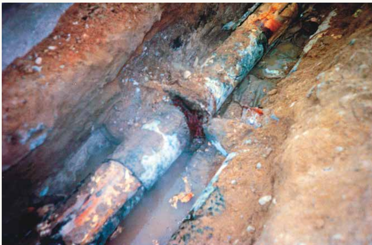
Eksempel på tæring af det eksisterende ledningsnet baseret på stålør i betonør
