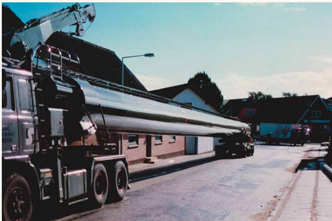
Den renoverede varmecentrals nye skorsten på 36 m blev leveret i stål og med 3 røgkanaler.
